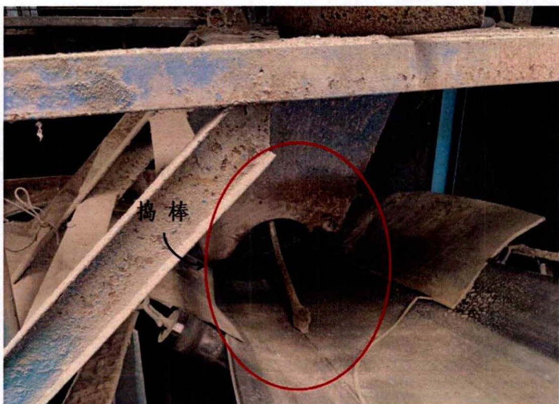
(图 5: 事故现场图片)
