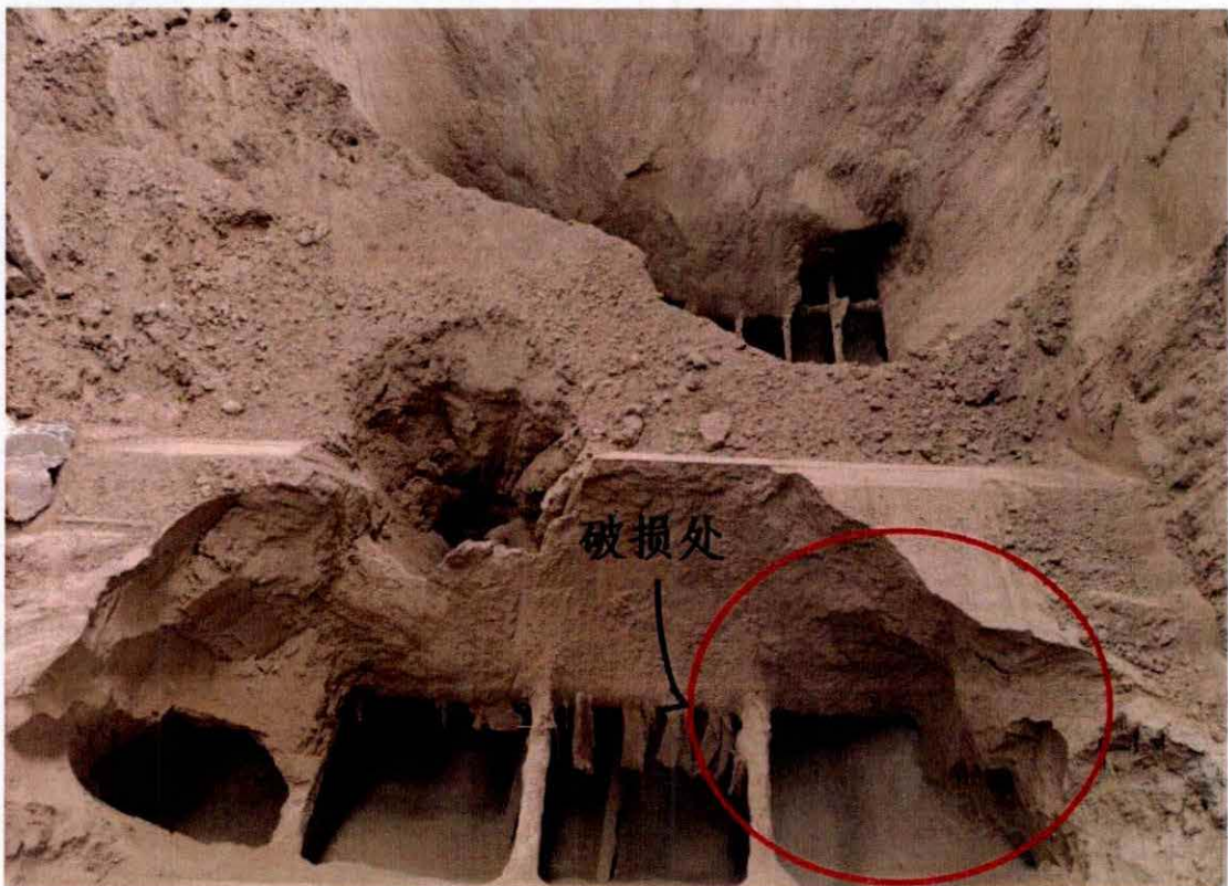
(图 3: 发生事故 1 号料仓现场图片)
