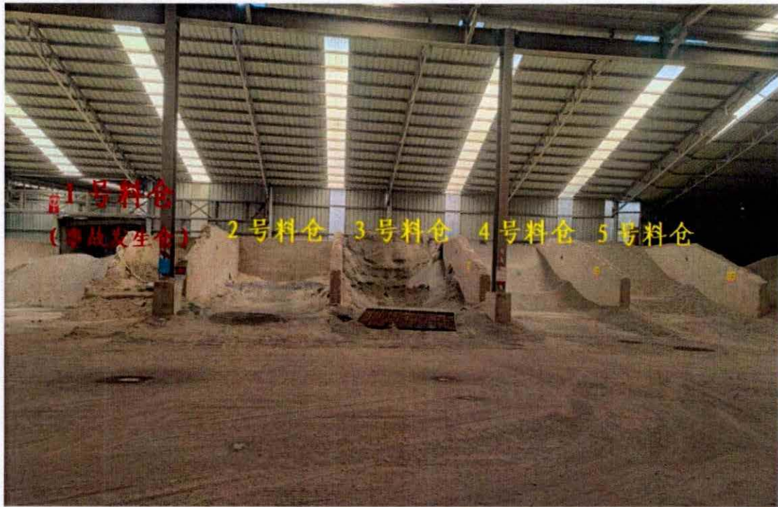
(图 2: 事故现场图片)
