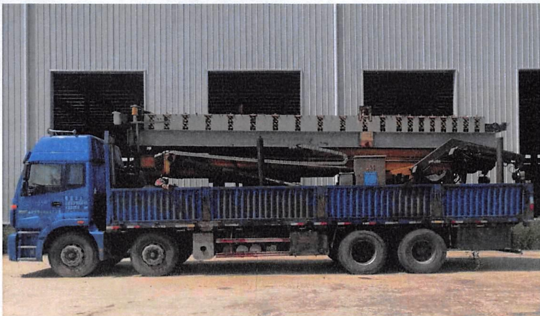
（图2-高空压板机现场位置图）
